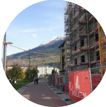
Hier entsteht ein Neubau. Entlang der Strecke sind seit 2011 knapp zwanzig dazugekommen!
